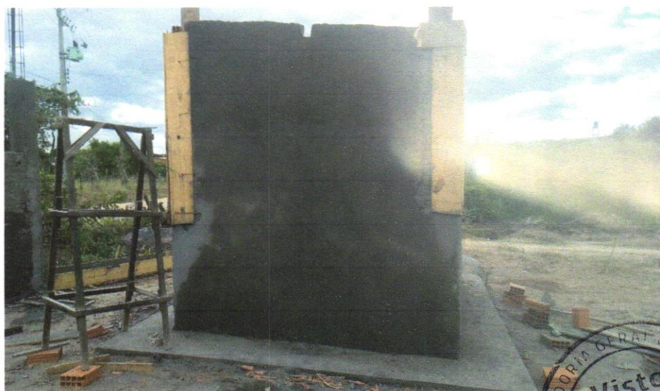
Foto 12 - EMBOÇO, PARA RECEBIMENTO DE CERÂMICA, EM ARGAMASSA TRAÇO 1:2:8, PREPARO MANUAL, APLICADO MANUALMENTE EM FACES INTERNAS DE PAREDES, PARA AMBIENTE COM ÁREA ENTRE 5M 2 E 10M 2 , ESPESSURA DE 20MM, COM EXECUÇÃO DE TALISCAS. AF_06/2014
